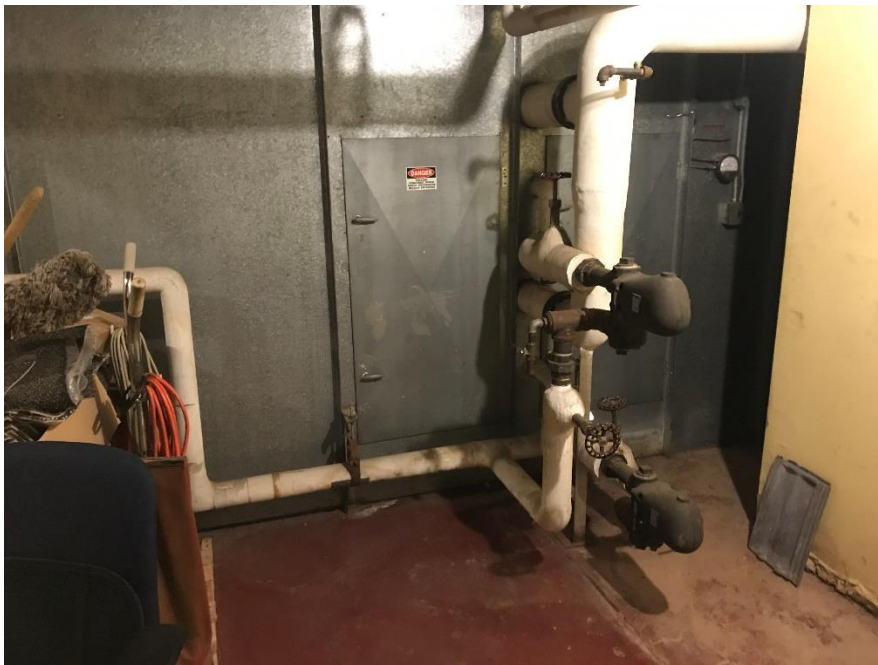
SUPPLY FAN SF-3 (1973) 1
